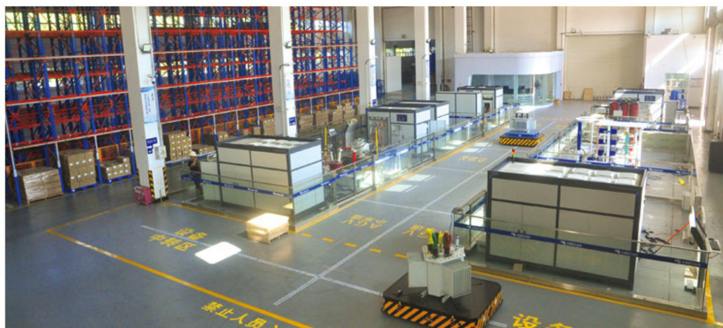
广东电网省级仓库智能巡检平台
