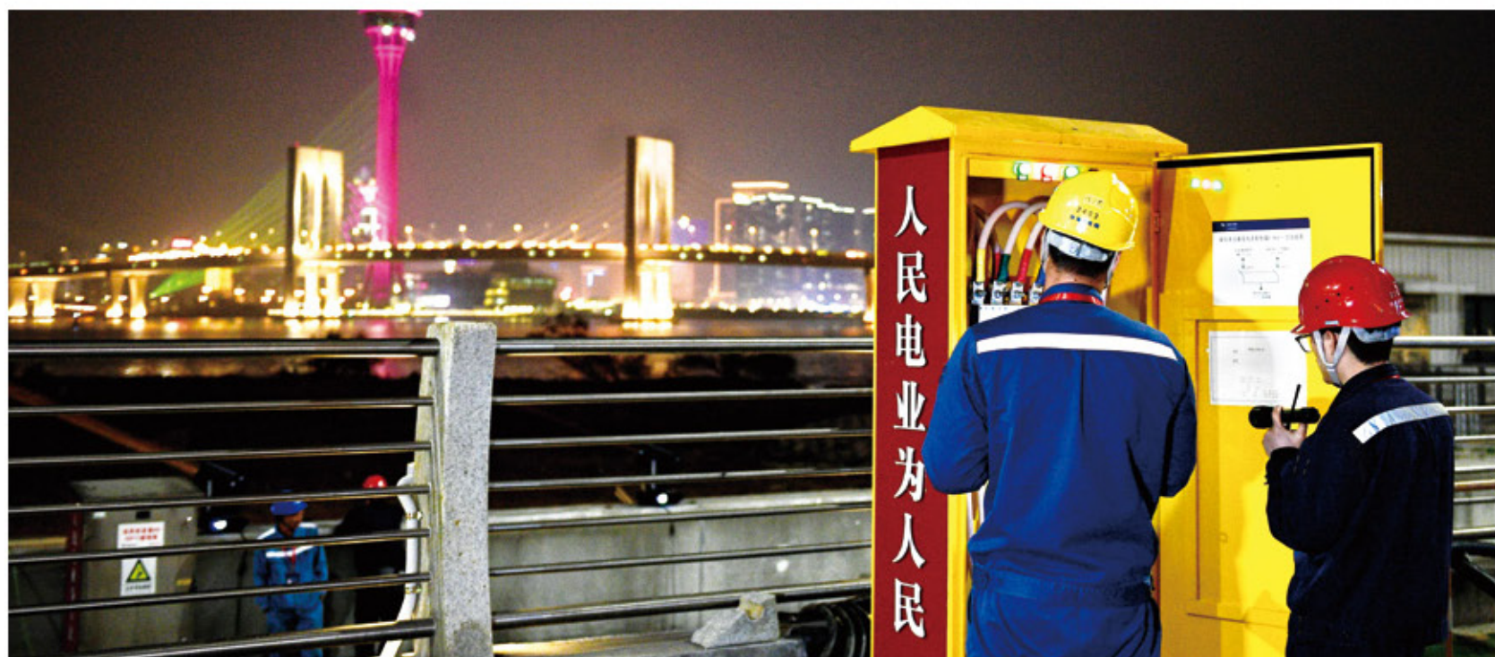
为确保庆祝澳门回归祖国 20 周年澳珠烟花汇演顺利举行，广东电网珠海供电局 100 余名保供电人员在现场以及周边变电站、线路展开不间断巡视和值守，保障欢庆时段的可靠供电。
