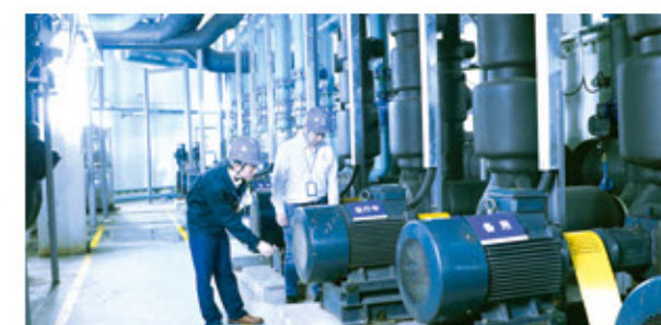
广东省佛山电力科技产业园冰蓄冷项目
