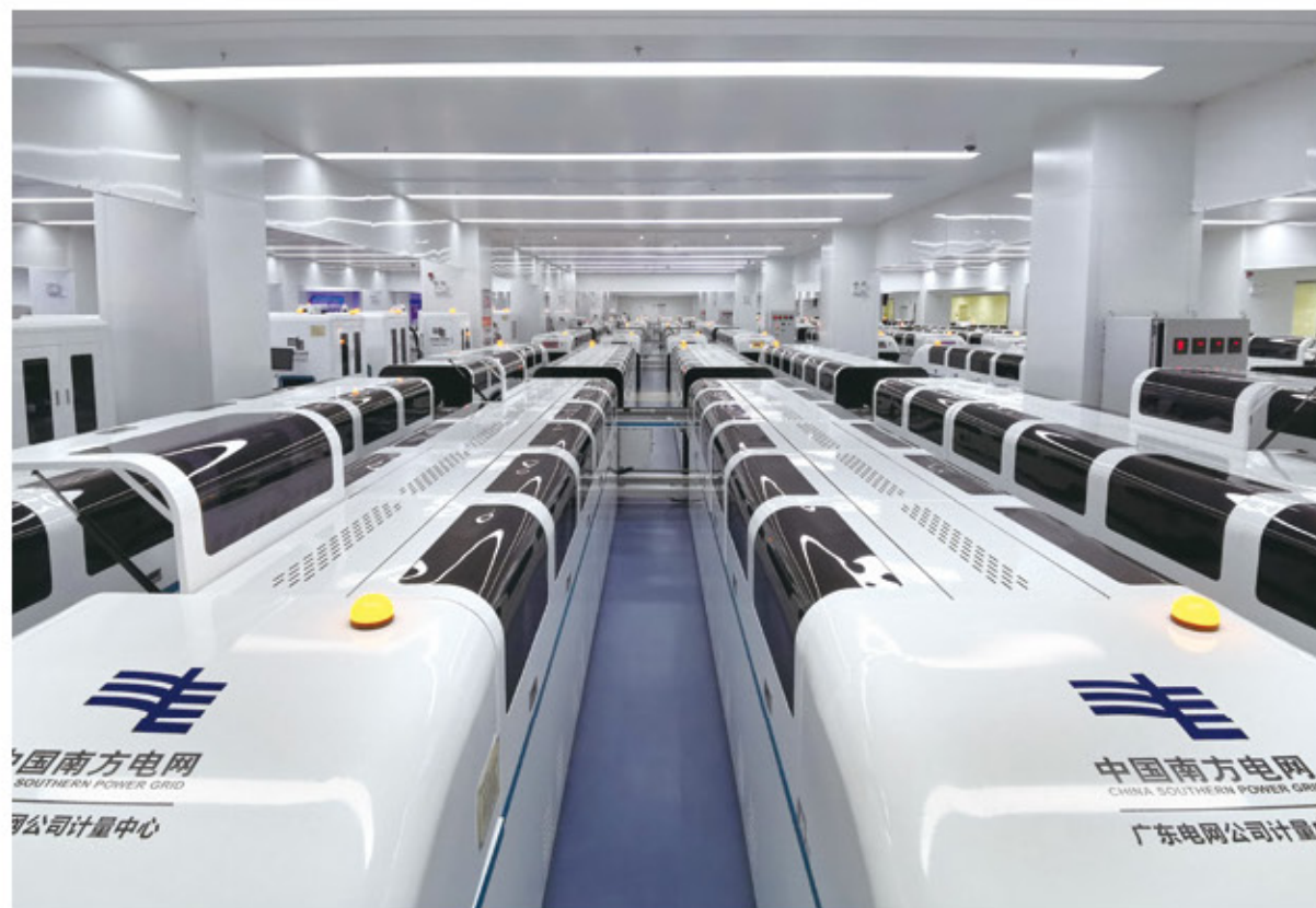
广东电网公司省级计量集中检定中心检定流水线
